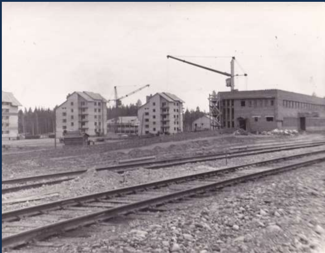
Строительство станции Улькан и посёлка железнодорожников специалистами из Азербайджанской ССР. Начало 1980-х гг.
